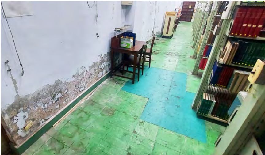
▲ 整修前研圖牆面與地板斑駁破損
